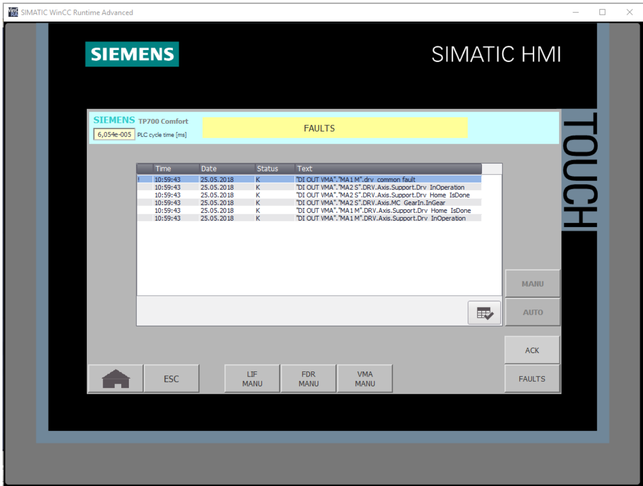
7.5 Abbild 05: HMI Störung- und Warnungsfenster. Eine quittierte Störung [!] und fünf Warnungen.
